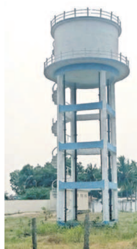
మిషన్ భగీరథ తాగునీటి ట్యాంక్
