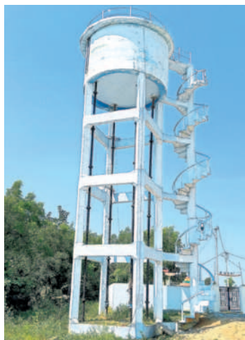
గ్రామంలో నిర్మించిన ఓవర్ హెడ్ ట్యాంక్
