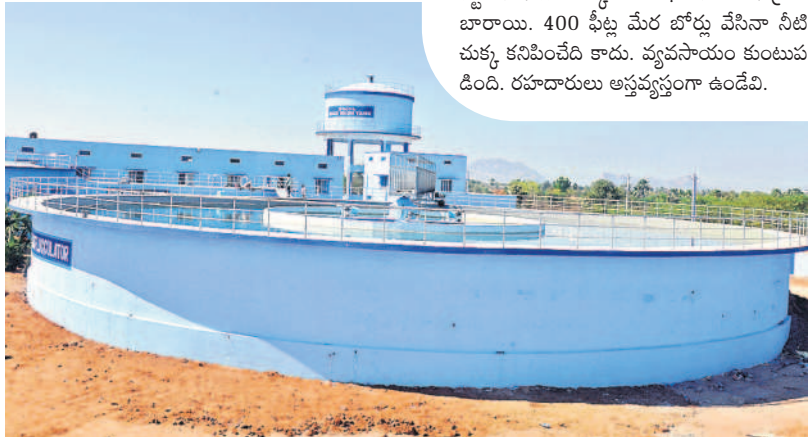
నూతనకల్లో ఏర్పాటు చేసిన మిషన్ భగీరథ ఫిల్టర్ బెడ్
