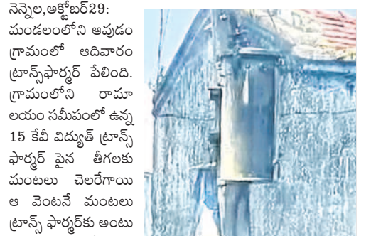
అవుడం గ్రామంలో పేలిన ట్రాన్స్ ఫార్మర్
