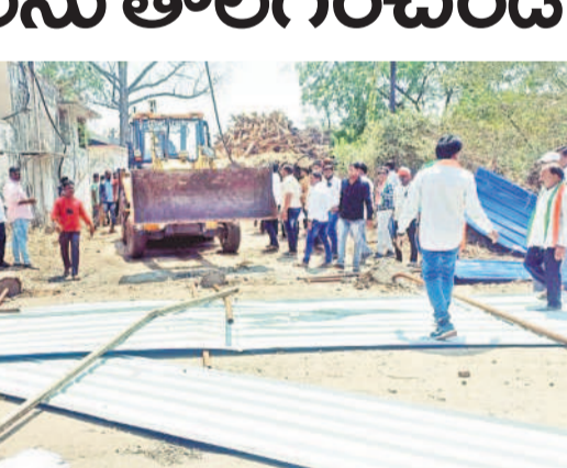
రోడ్డుకు అడ్డంగా ఉన్న రేకులను తొలగించు
