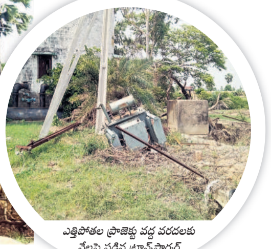
ఎత్తిపోతల ప్రాజెక్టు వద్ద వరదలకు నేలపై పడిన ట్రాన్స్ ఫార్మర్
