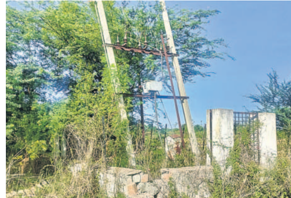
చిలిపిచెట్ల మండలం చందూర్ ఎత్తిపోతల ప్రాజెక్టు వద్ద ద్వారంపైని ట్రాన్స్మిషన్ టవర్
