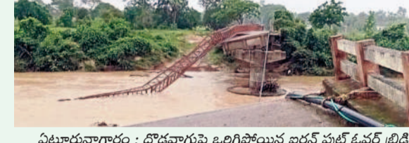
ఏటూరునాగారం : దొడ్లవాగుపై ఒరిగిపోయిన వరద నీరు పుట్టి ఒవర్ బ్రిడ్జి
