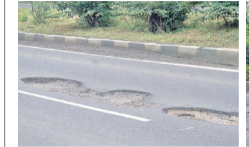
గుడిహత్నూర్ మండలం సీతాగిరి వద్ద రోడ్డుపై గుంతలు
