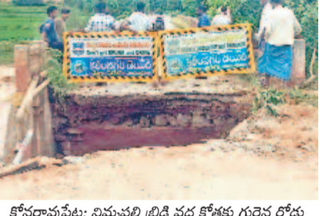
కోనరావుపేట: నిమ్మపల్లి బ్రిడ్జి వద్ద కోతకు గురైన రోడ్డు
