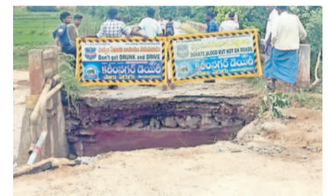
కరీంనగర్: నిమ్మపల్లి బ్రిడ్జి వద్ద కోతకు గురైన రోడ్డు
