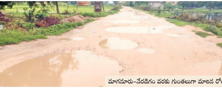
మాగనూరు - నేరడిగం వరకు గుంతలుగా మారిన రోడ్డు
