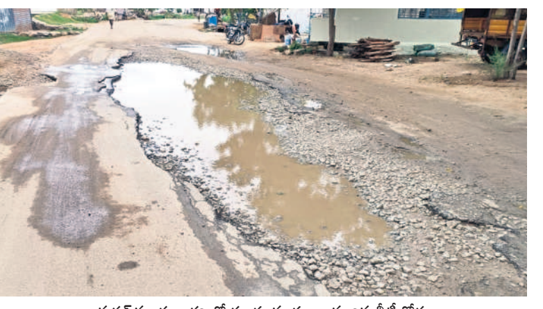
మక్తల్ మండలం కల్వల్ గుంతలమయంగా మారిన బీటీ రోడ్డు
