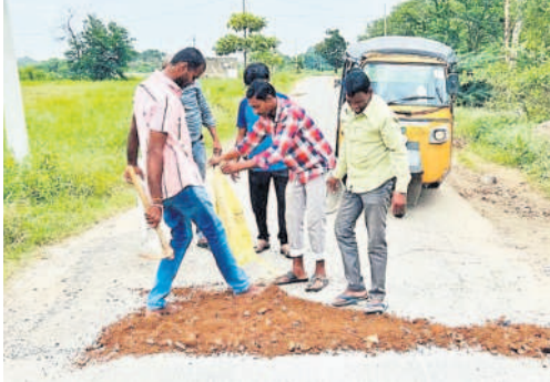
గాడవల్లి గ్రామ సమీపంలోని రోడ్డుపై ఏర్పడిన గుంతలలో మట్టి పోసి చదును చేస్తున్న ఆటో డ్రైవర్లు
