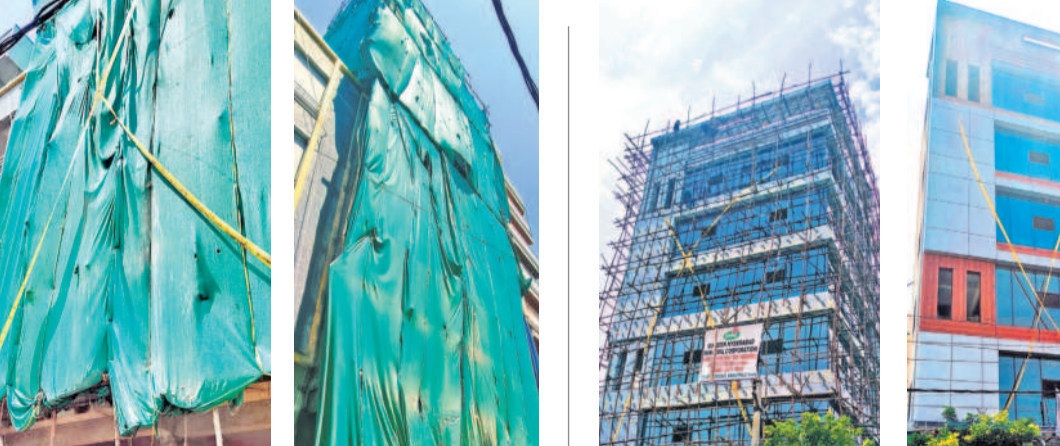
కేపీహెచ్ఐ కాలనీ 15వ ఫేజీలో నిర్మాణ సంబంధి 81లో అనుమతులకు విరుద్ధంగా భవనం నిర్మించారని బిల్డియా అధికారులు గుర్తించారు.. ఆ భవనాన్ని సీజ్ చేశారు. కానీ.. సీజ్ అలాగే ఉంది.. వారం రోజులతో సదరు నిర్మాణాధికారులు భవనం నిర్మించినట్లు ప్రాంతం.. ఫైనల్ సైట్ చేశారు. మరొక రోజులో జీహెచ్ఎంసీ సీజ్ అంతకు సరిగ్గా ఉంది. ఈ వ్యవహారంలో పెట్టె అవుతుంది.. చేతివాలం పనిచేసినట్లు ప్రధానం సాగుతున్నది.
