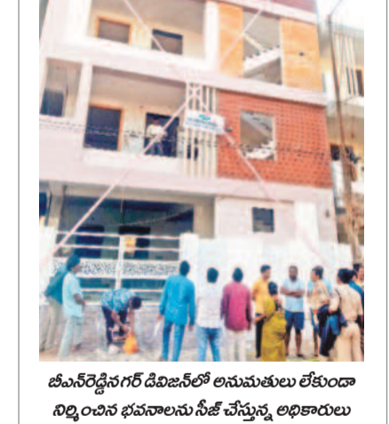
జనార్దెన్ గర్ డివిజన్ లో అనుమతులే లేకుండా నిర్మించిన భవనాలను సీజ్ చేస్తున్న అధికారులు
