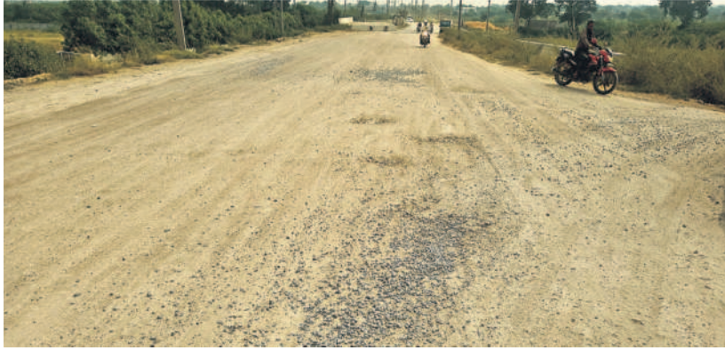
ముట్టి తీరి అసంపూర్ణంగా ఉన్న మీర్ఖాన్పేట్ రోడ్డు
