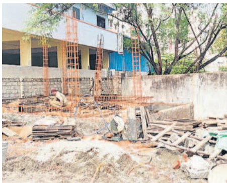
సుభాషినగర్ డివిజన్, క్రిష్ణమూర్తివగర్ కాలనీలో నాలాల బఫర్ జోన్ లు అక్రమించి చేపడుతున్న నిర్మాణం
