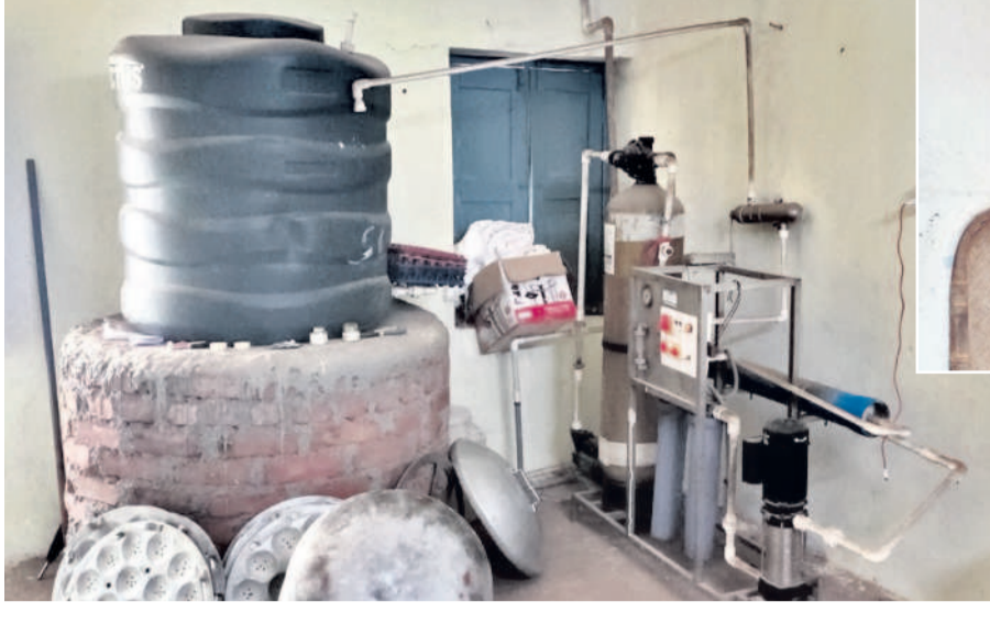
లింగంపేటలోని ఎస్సీ వసతి గృహంలో పనిచేయని పూర్తిఫయర్
