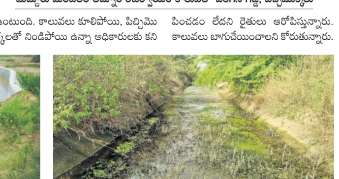
ముద్దూరు మండలం లద్దూర్ లిజిర్యామర్ కాలువలో పెరిగిన గడ్డి, పిచ్చిమొక్కలు
