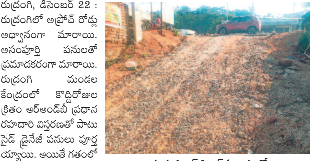
రుద్రంగి బస్ స్టాండ్ ఏరియాలో ప్రమాదకరంగా ఉన్న అప్రోచ్ రోడ్డు
