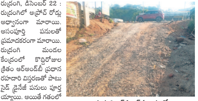
రుద్రంగి బస్ స్టాండ్ ఏలయలో ప్రమాదకరంగా ఉన్న అప్రోచ్ రోడ్డు
