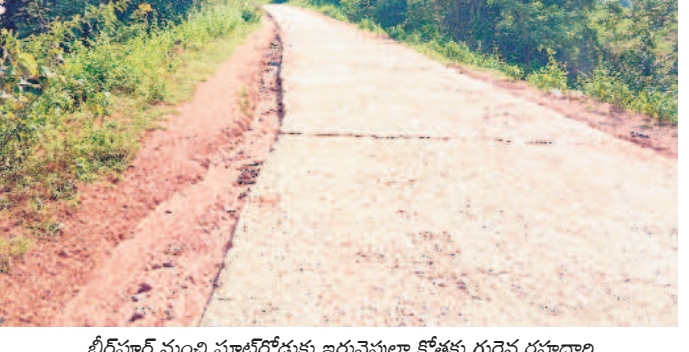
బీర్పూర్ నుంచి ఘాట్ రోడ్డుకు ఇరువైపులా కోతకు గురైన రహదారి
