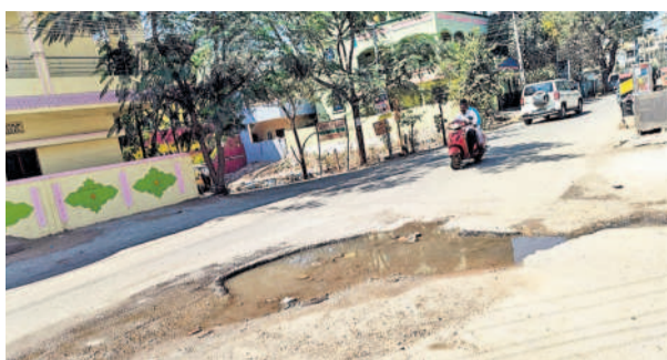
మేడ్చల్-కిష్కాపూర్ దారిలో రోడ్డు పనుల భగీరథ నీటి లీకేజీతో ఏర్పడిన గుంత
