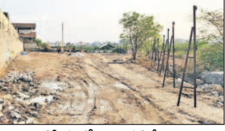
దామర చెరువు సమీపంలో అక్రమ ప్రహరీ నిర్మాణం
